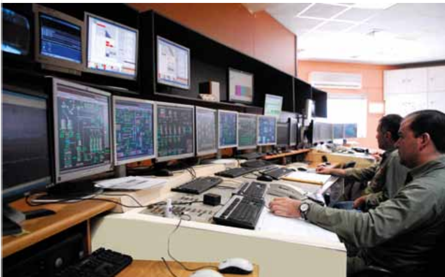
Κέντρο Ελέγχου στο εργοστάσιο Μηλακίου
